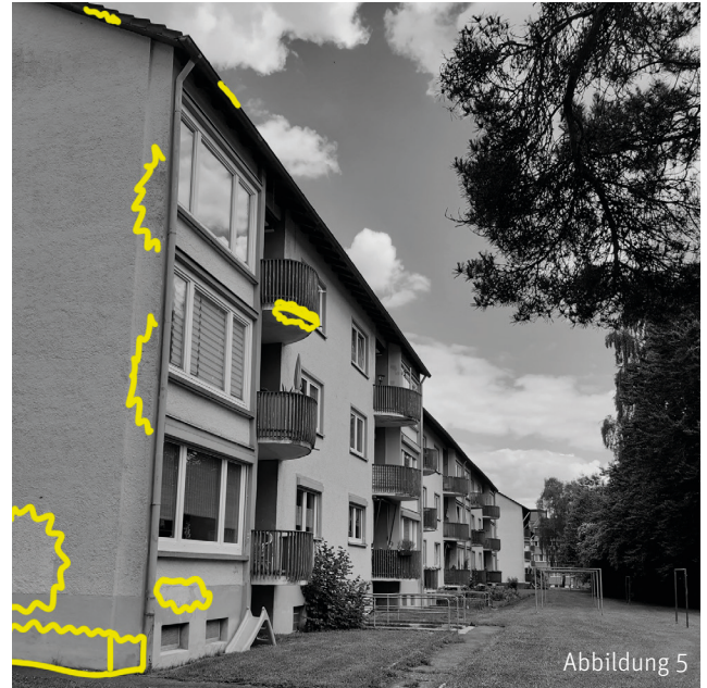
Bauliche Mängel: Der Lebenszyklus vieler Bauten neigt sich dem Ende und Sanierungs- oder Erneuerungsmaßnahmen sind absehbar.
